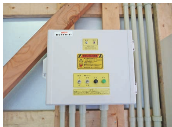
▲コントロールBOX
