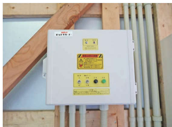
▲コントロールBOX
