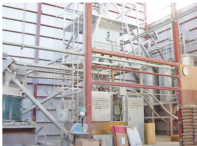
▲自家配合設備
